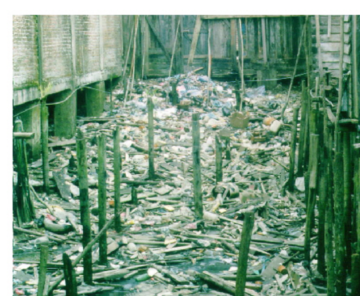
Contraste entre tipologías constructivas, basuras en restos de vivienda
