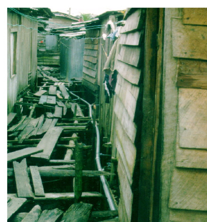
Sistema de asentamiento. Pasajes de difícil acceso en caso de incendio
