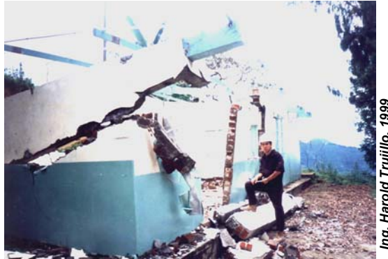
Figura 27. Colapso de una edificación por falta de confinamiento en el terremoto del 25 de enero de 1999 en el Eje Cafetero.
