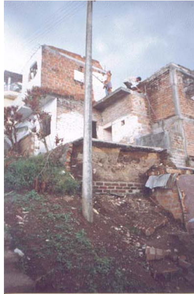
Figura 14. Edificaciones sobre terrenos inestables, en el Eje Cafetero.
