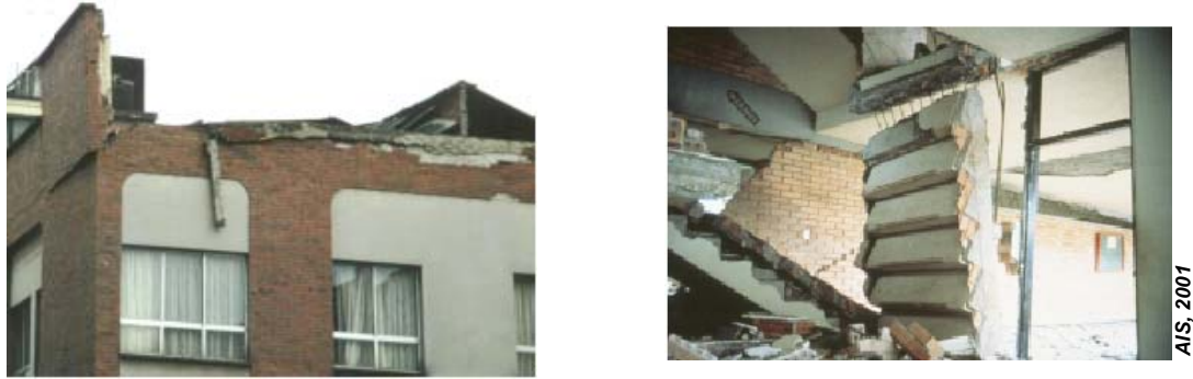
Figura 30. Falla en elementos estructurales mal conectados o diseñados.
