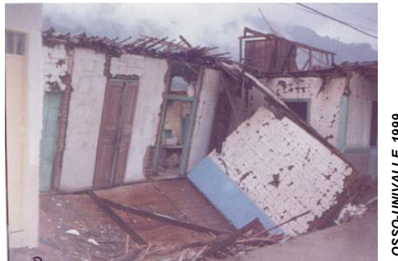
Figura 24. Colapso de una edificación de bahareque por falta de estabilidad.
