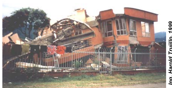
Figura 26. Colapso de una edificación por deficiencias en su estructuración
