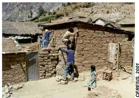
Figura 41. Vivienda de adobe, en el Perú, con deficiencias constructivas.
