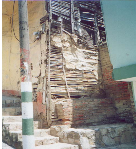
Figura 11. Edificación de bahareque deteriorada en el barrio San Antonio.
