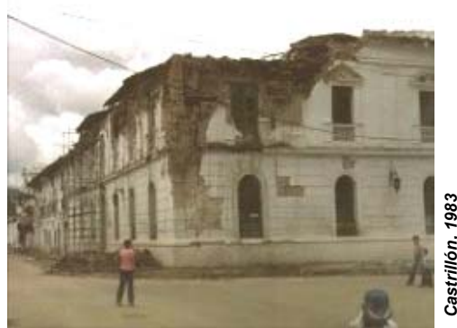
Figura 40. Edificación con gran cantidad de vanos, afectada por el terremoto de Popayán el 31 de marzo de 1983
