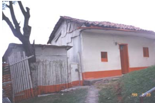
Figura 10. Vivienda construida en materiales de baja calidad.
