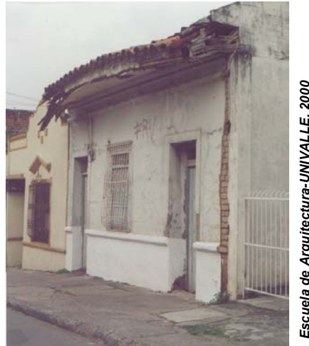
Figura 31. Vivienda en mal estado de conservación en el barrio San Antonio.
