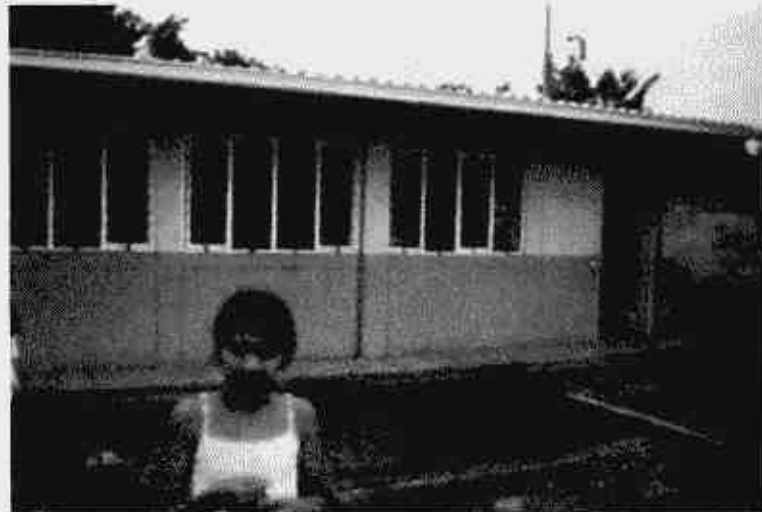
Edificación construida recientemente. Presencia de columna corta por falta de separación entre el inicio de la abertura y el muro.
