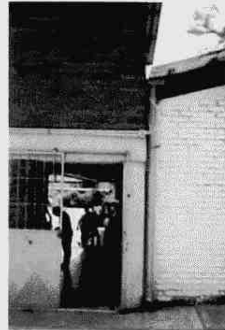
Problemas de colindancia entre bloques.
