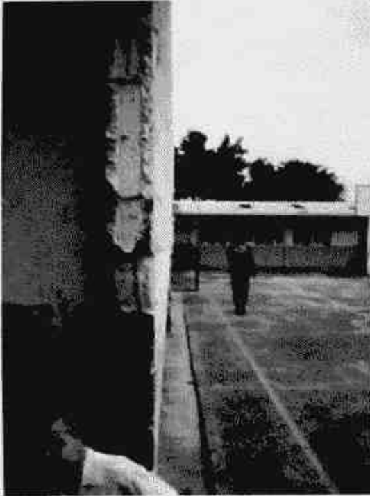
Muro estructural pandeado por asentamiento y mala constructiva.
