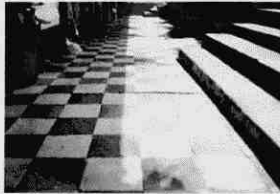
Desniveles en los pisos.
