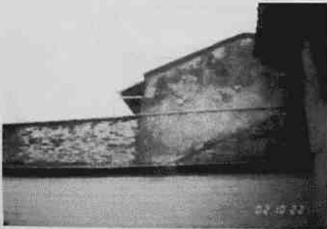
Edificación intermedia, problemas de colindancia con edificaciones vecinas.
