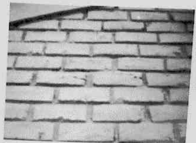
Mala calidad de las unidades de mampostería.
