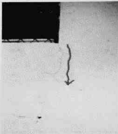
Fisuras en la mampostería.
