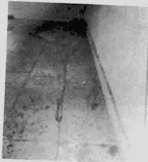
Agrietamiento de los pisos y de los antepechos del restaurante escolar, a causa de asentamientos del terreno.
