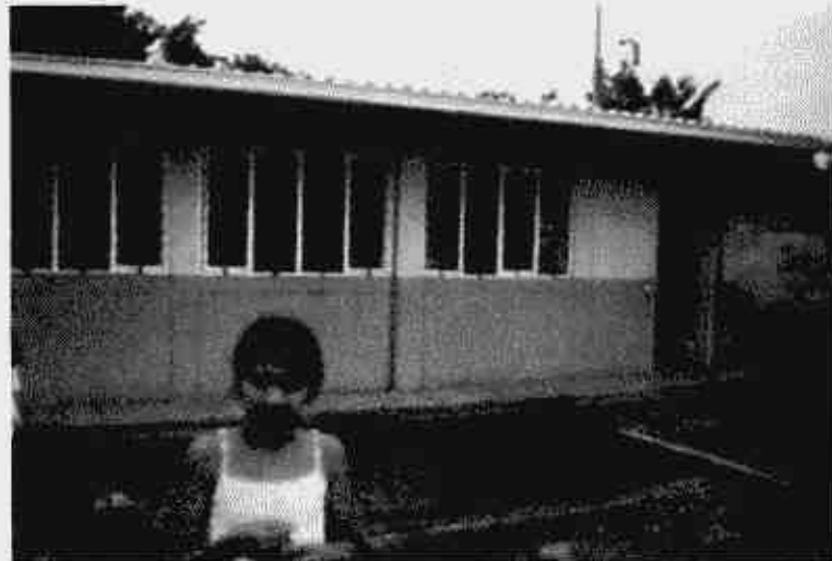
Edificación construida recientemente. Presencia de columna corta por falta de separación entre el inicio de la abertura y el muro.
