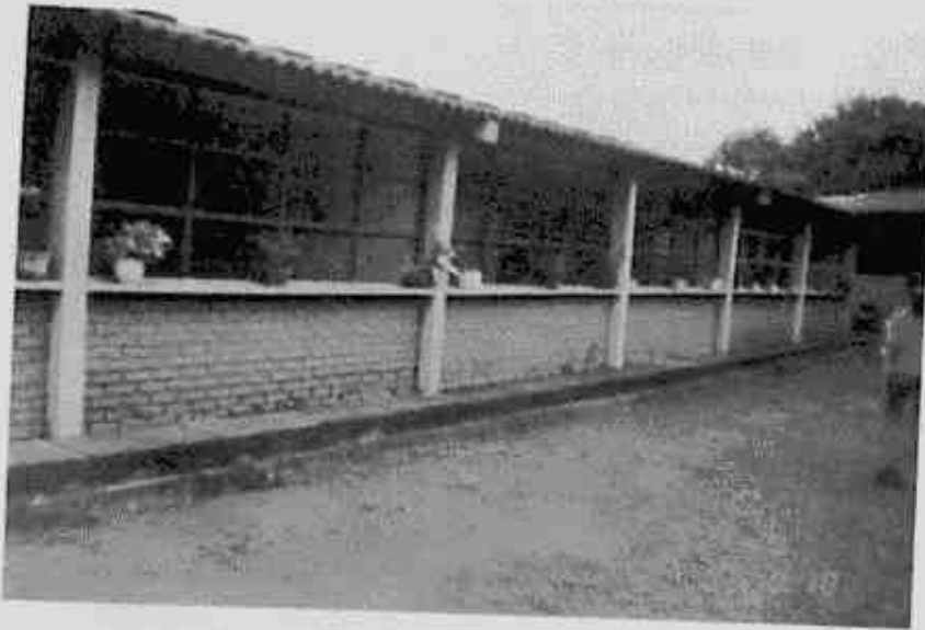
Muros estructurales en una sola dirección, por presencia de grandes aberturas a todo lo largo de la otra. Presencia de columna corta.
