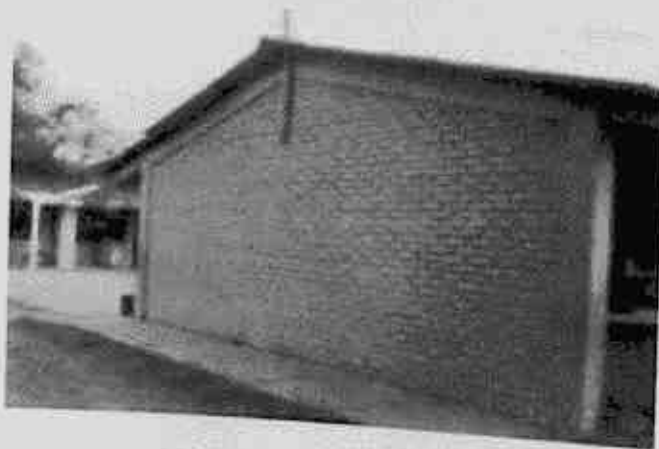
Distancia entre elementos de confinamiento vertical, mayor a la altura de entrepiso.
