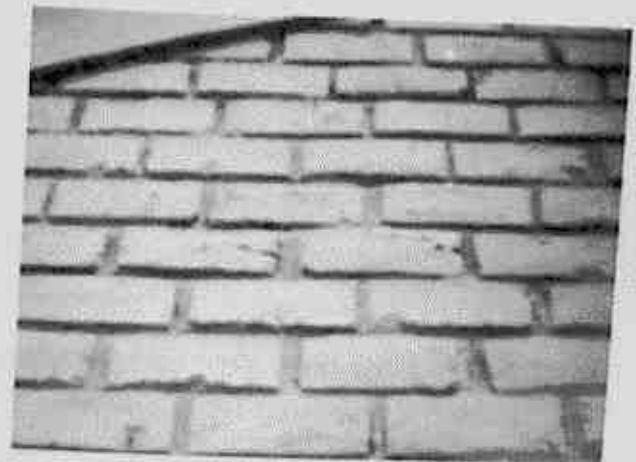
Mala calidad de las unidades de mampostería.
