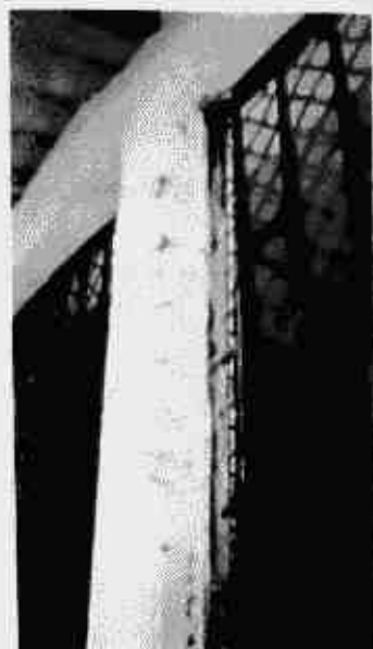
Acero expuesto por mala fundición del elemento.
