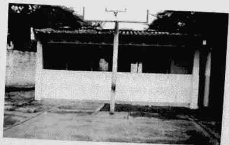
Grandes aberturas en una dirección. Presencia de columna corta.
