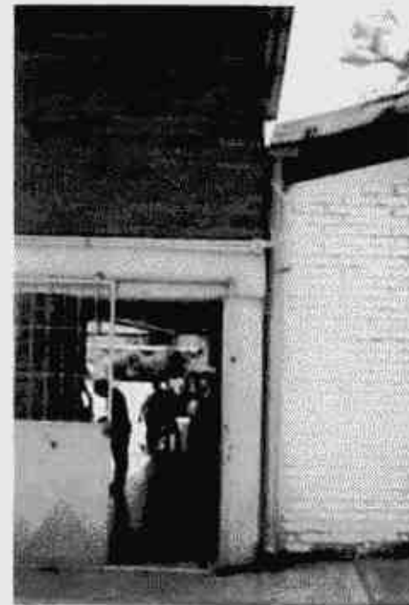
Problemas de colindancia entre bloques.
