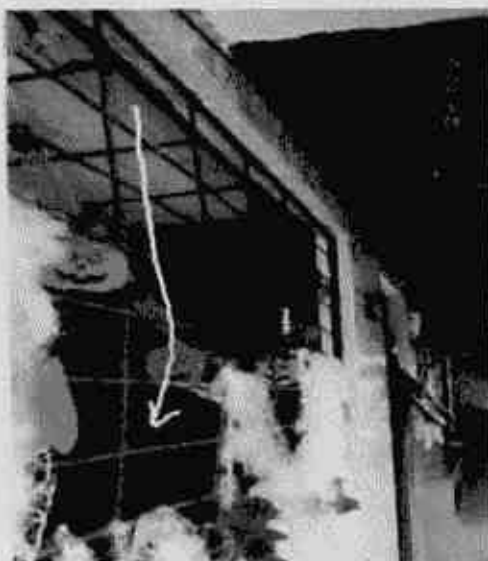
Deflexión de la viga, Visible en deformación de la reja de la ventana.
