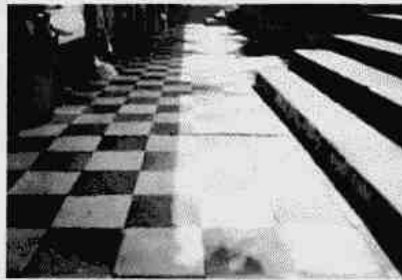
Desniveles en los pisos.
