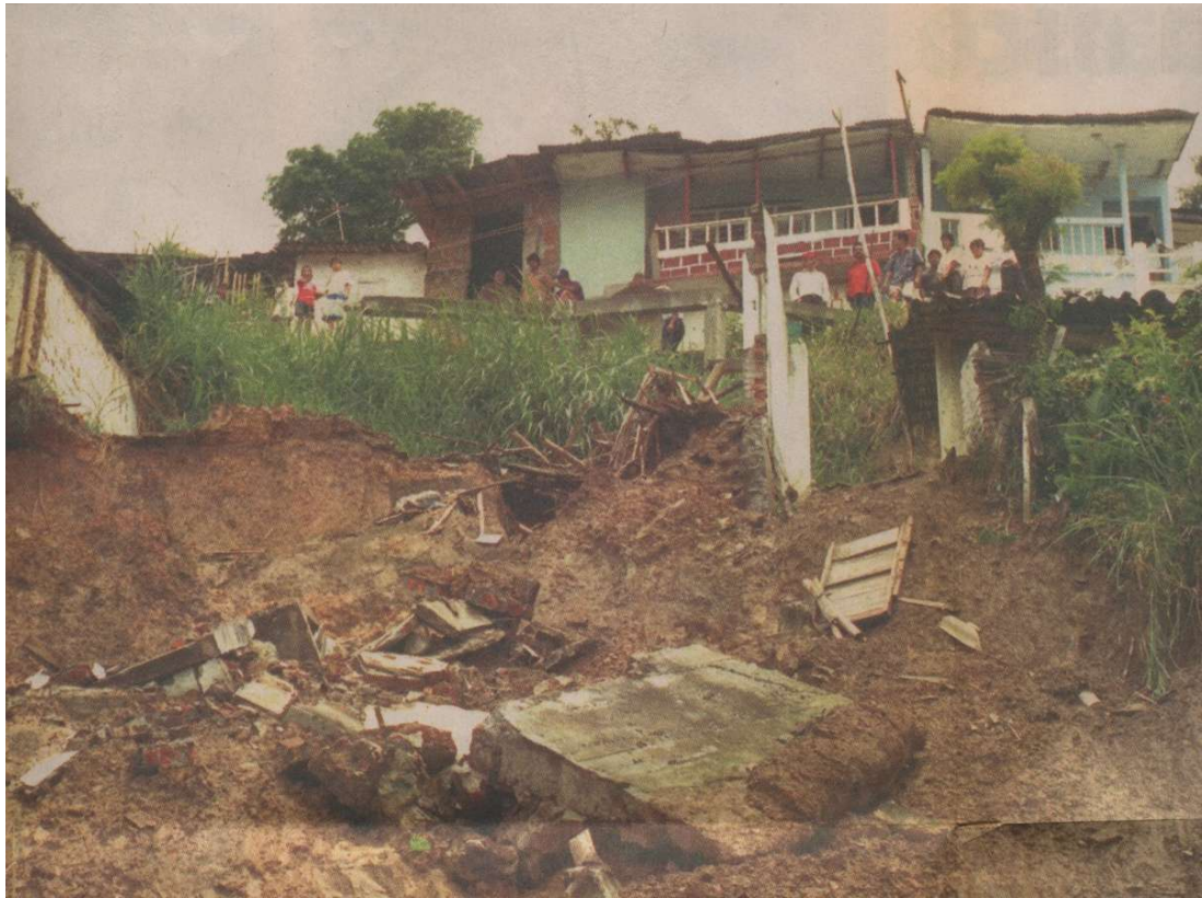
Figura 46. Deslizamiento en el Sector Las Minas, parte alta de Siloé, el 30 de marzo de 1997. El deslizamiento fue provocado por el desagüe de un tubo del acueducto construido por la misma comunidad. Cuatro personas perdieron la vida y tres viviendas quedaron destruidas. Siete familias, conformadas por 22 adultos y 15 niños debían evacuar la zona de manera inmediata. Fuente: El País, Marzo 31 de 1997. P.1 y B6.
